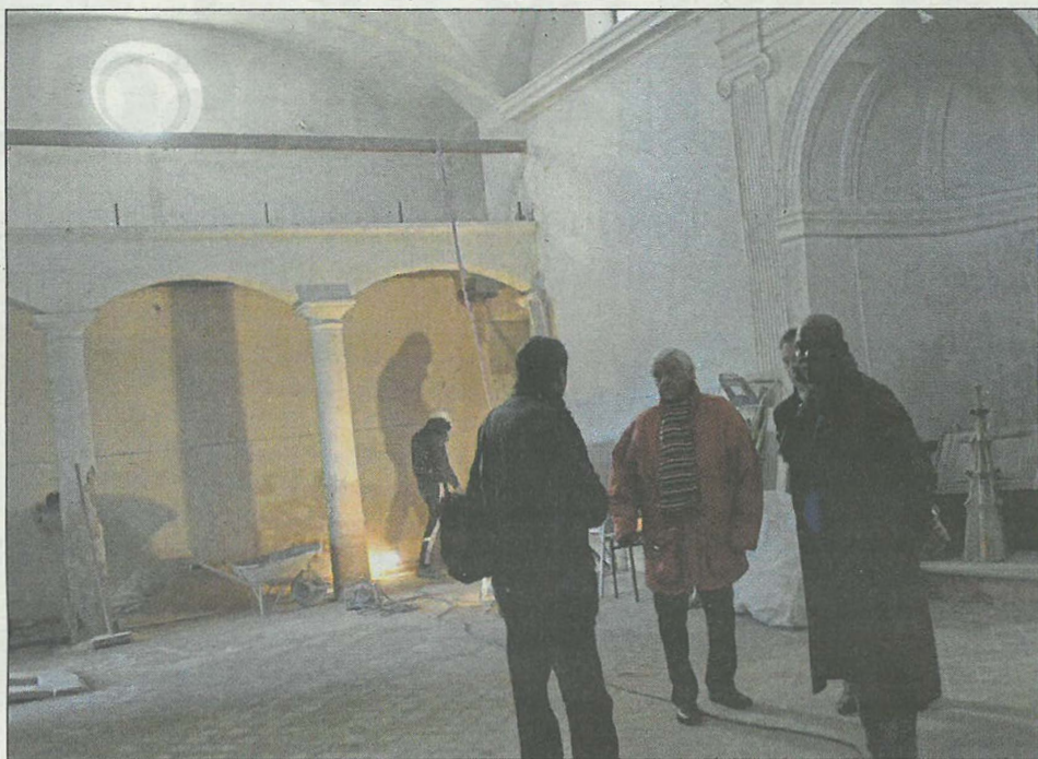
La mezzanine a déjà été consolidée, les alcôves dégagées et des espaces utilitaires aménagés, comme on a pu le constater lors de cette visite de chantier.
